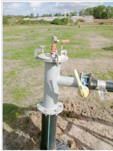
Figura D.37 - Cabeça de poço de captação de gás metano Fonte: do autor.
