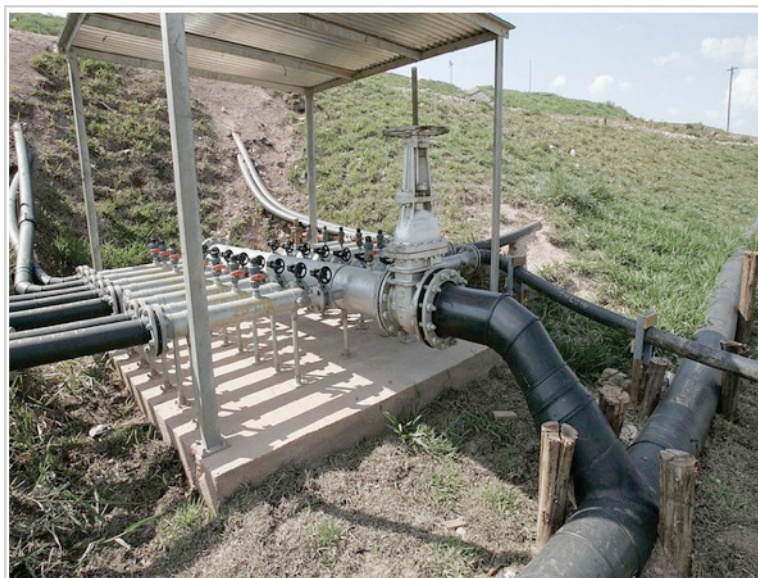
Figura D.38 - Unidade de controle do fluxo de gás metano (manifold) Fonte: Vidal Cavalcante/AE
